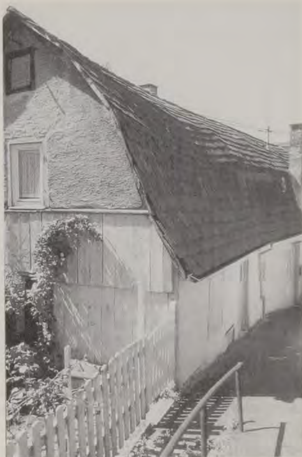
Das heutige Haus Koppenberg 8 von der Rückseite aus gesehen. Das Gebäude, das ursprünglich nur vom Weg bis zum Fallrohr der Dachrinne reichte, war schon vor 1832 bis zur heutigen Größe verlängert worden.
