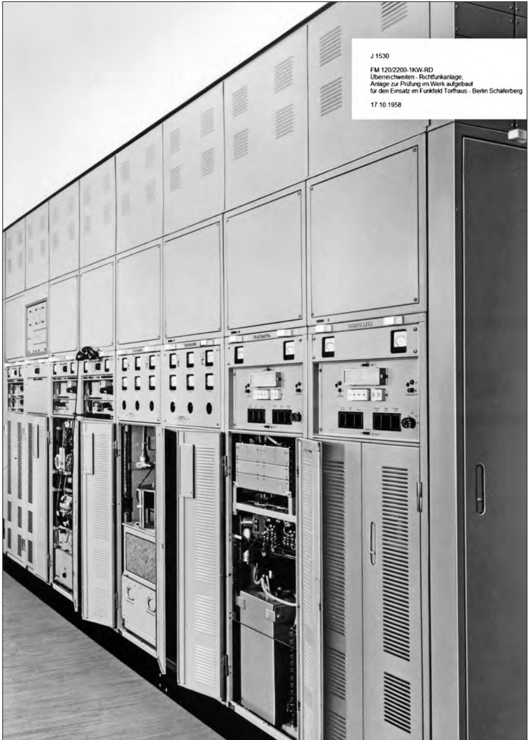
Sendeempfangsanlage FM 120/2200 1 kW RD1.
