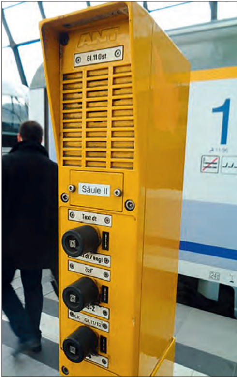
DIKOS-210-Rufsäule G 80 im Berliner Hauptbahnhof (Aufnahme von 2019).
