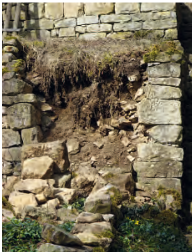
Einstürzende Altbauten: An diesem eingefallenen Stück Trockenmauer, aufgenommen in ehemaligen Weinbergen im Leudesbachtal bei Markgröningen, wird ein konstruktiver Baufehler sichtbar. Auf der rechten Seite waren die Steine zu wenig verzahnt. Zur Reparatur genügt es nicht, die Lücke wieder zu füllen, vielmehr muss ein mindestens doppelt so langes Mauerstück bis auf die untersten Steinlage abgebrochen und fachgerecht neu aufgesetzt werden.
