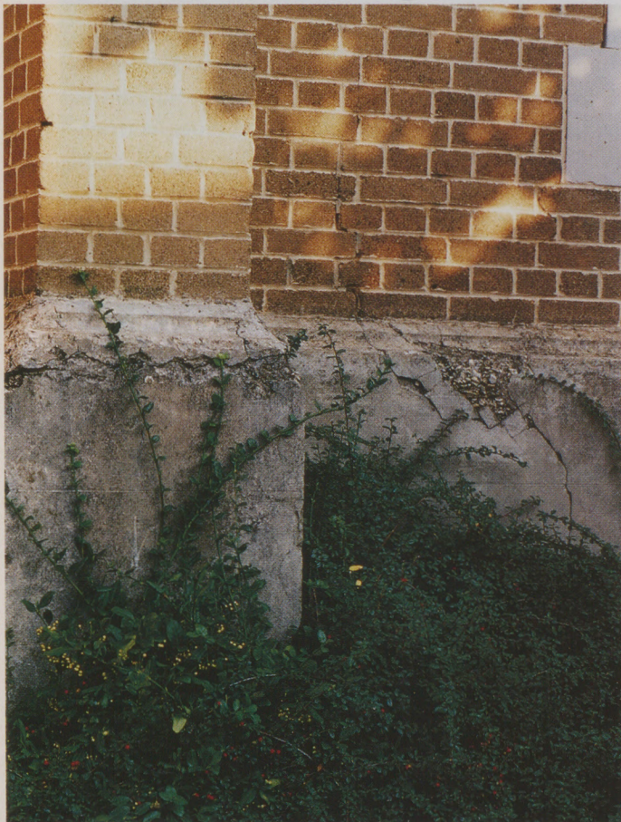
Auflösungserscheinungen im Sockelbereich, die schon auf das Mauerwerk übergreifen haben.
