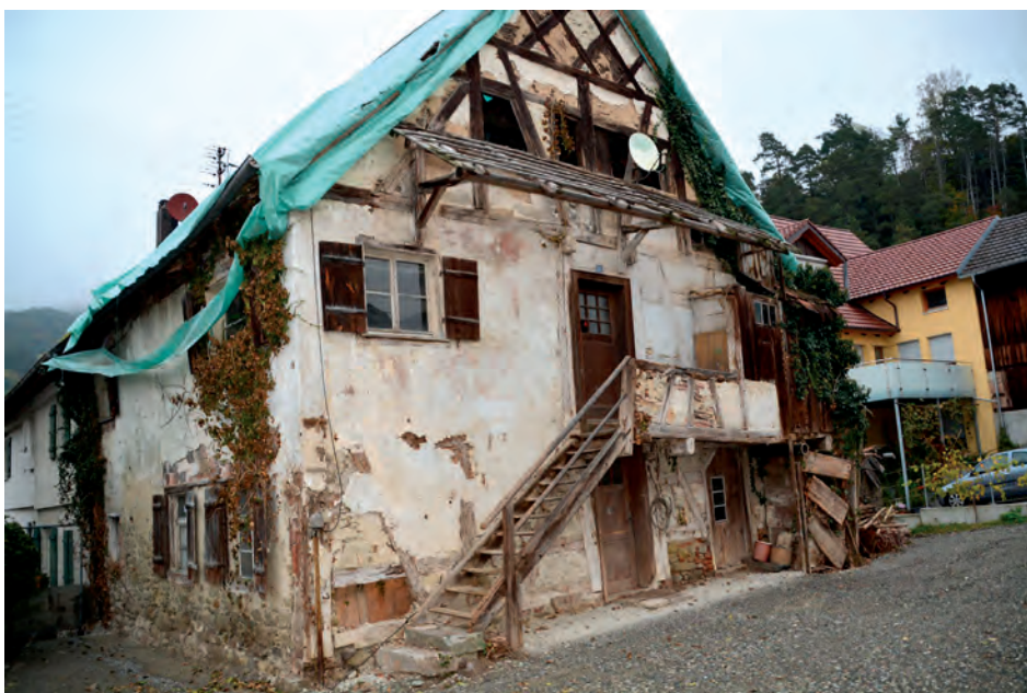
Erschreckend: der Zustand des einsturzfährdeten Hauses 2014 mit notgesichertem Dach.
