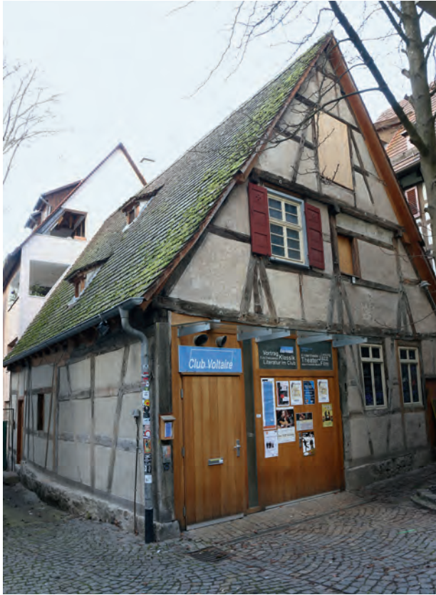
Südwestansicht des Club Voltaire im Herbst 2019 mit freigelegtem und repariertem Fachwerk und neu gestaltetem Zugang.
