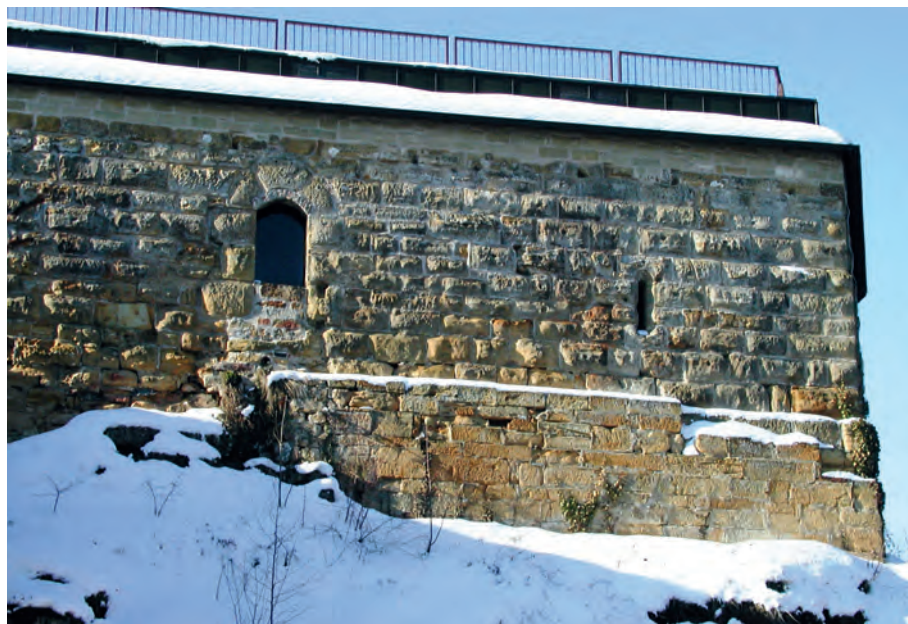
NO-Ecke der Kernburg mit dem «glatten» Quadersockel von Haus II, dem sogenannten «Ostbau».
