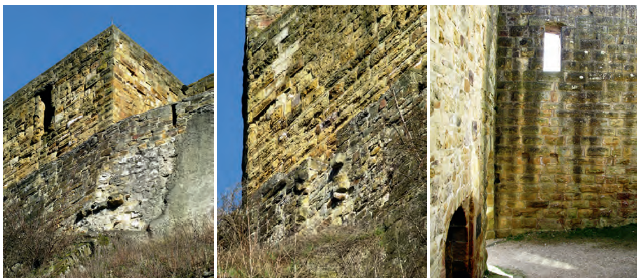
Links: Unverkennbar ist die alte Baunaht am Turm D an der inneren Zwingermauer. Mitte: Ehemaliger Durchgang mit deutlicher Baunaht an der inneren Zwingermauer, oberhalb davon der nachträglich hergestellte Durchgang in der Außenmauer der Kernburg. Rechts: Innenseite der Kernburg-Außenmauer mit dem nachträglich hergestellten Durchgang zu Turm D.
