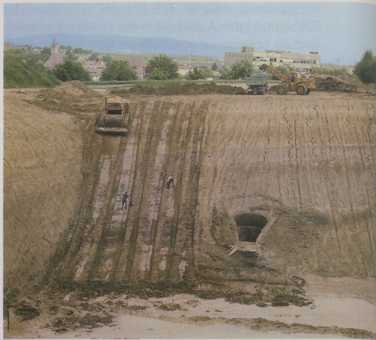
Mit dem Lehmabbau in der Lehmgrube von Schmiden konnten sich auch die Archäologen gefahrlos in die Tiefe arbeiten. In der Mitte, am Hang, der Brunnenschacht in der Viereckschanze. Frühjahr 1980.
