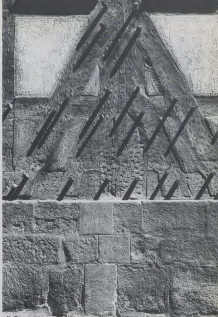
Am Sockel des Alten Rathauses in Esslingen werfen die Holznägel, die die Verblattungen sichern, lange Schatten.
