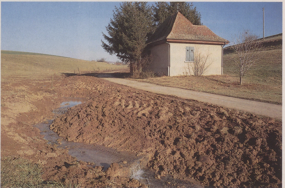
Der Sulzbach nach Abschluß der Erdarbeiten: Deutlich sichtbar sind die möglichst unregelmäßig gestalteten Ufer. Aufgenommen im Dezember 1987.
