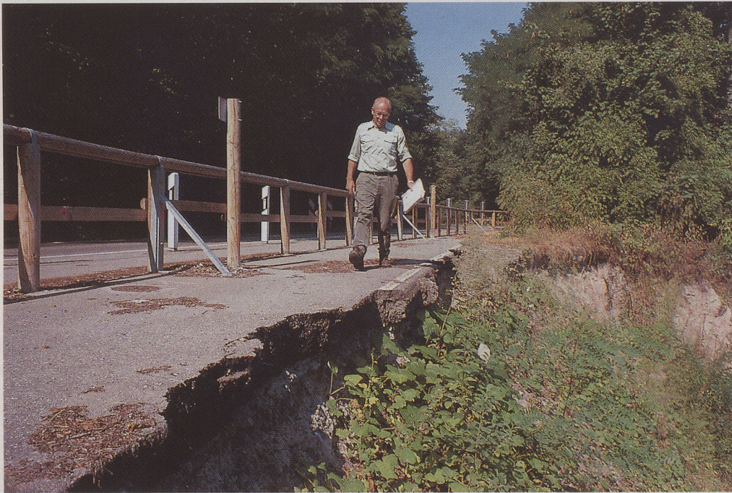
Der Stuttgarter Forstdirektor Fritz Oechßler schreitet an der Stelle über die Kreisstraße K 1659, an der auf 25 Meter Länge Bankett und Teile der Fahrbahn abgerutscht sind. Er kämpft darum, diese überflüssige Verbindung Solitude–Schillerhöhe bis auf den Busverkehr zu schließen.
