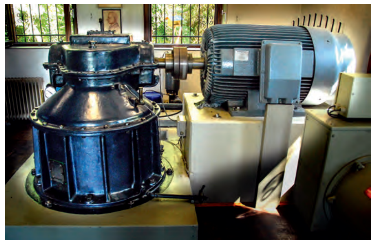
Altbewährte Technik – erneuerbare Energie: Im Krafthaus des Wassertriebwerks Berg-Kasernen wird seit 1910 Strom produziert. Das blaue Getriebe überträgt den Dreh der Turbine – unter dem Stockwerksboden – auf den grauen Generator.
