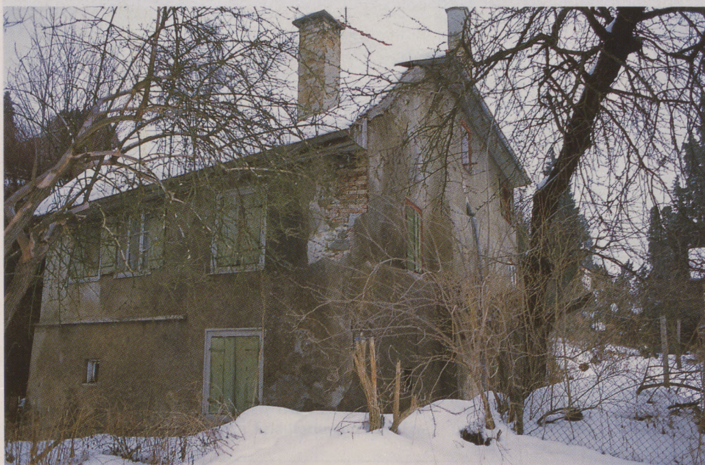
Südwestansicht des Hauses Luziengasse 8 in Überlingen im November 1985. Die Südwestecke war durch eindringendes Dachwasser völlig zerstört und mußte erneuert werden. Durch aufsteigende Feuchtigkeit und mangelnde Lüftung breitete sich im Keller und Erdgeschoß der Hausschwamm aus.
