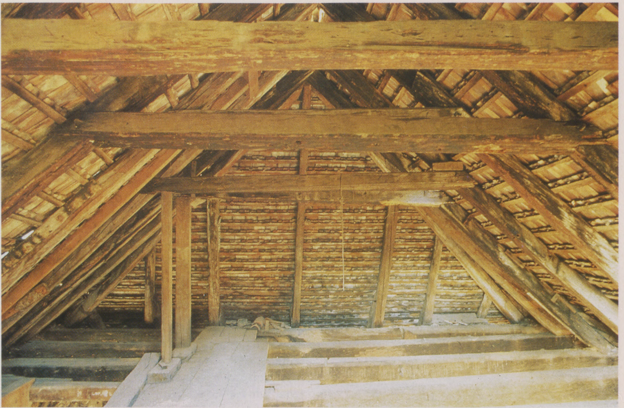
Das Dachgeschoß wurde laut dendrochronologischer Untersuchung um 1350 so umgebaut, wie es im Bild zu erkennen ist. Fast alle Balken aus Tannenholz konnten wieder verwendet werden. Die Imprägnierung mit Ruß und Tierblut verhinderte den Wurm- und Käferbefall.
