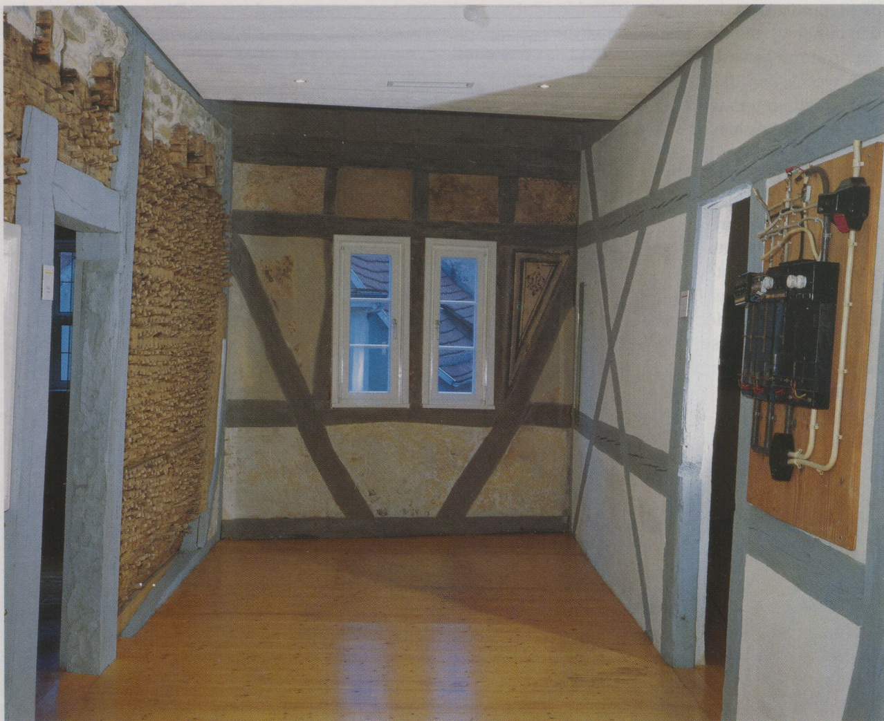
Ein Blick in den Flur im Obergeschoß zeigt die Arbeit der Restauratoren und Handwerker. Links eine freigelegte Pflöckewand, vorne eine freigelegte, rechts eine neu bemalte Wand; die Bodendielen sind neu angefertigt.
