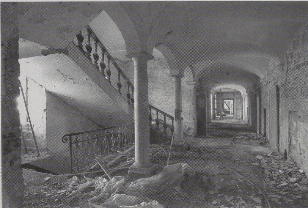
Abblätternde Farben, bröckelnder Putz, beschädigte Säulen: Vor der Renovierung des Konventsbaus haben Treppenhaus und Korridor im ersten Stock einen traurigen Anblick geboten.
