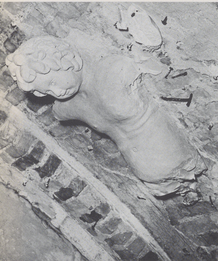
Ein halbzerstörter Putto im Gewölbe. (Foto: J. Hättig, 1947)
