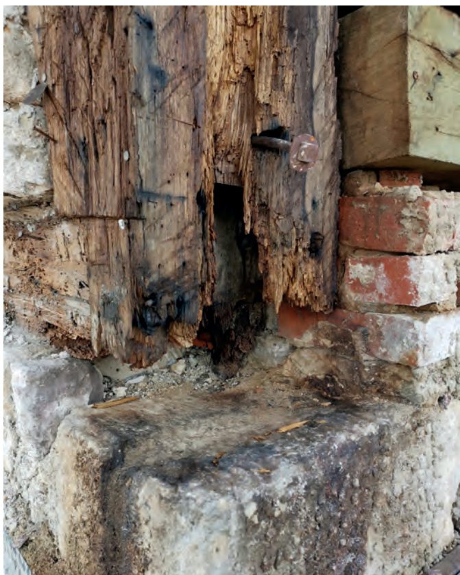
Verfallener Eckständer in der Kirchturm-Norwestecke
