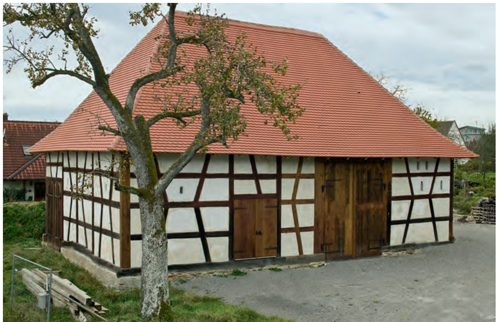
Auch nach der Sanierung hat sich der Charakter des Torkels als landwirtschaftliches Gebäude ohne Einbußen erhalten.
