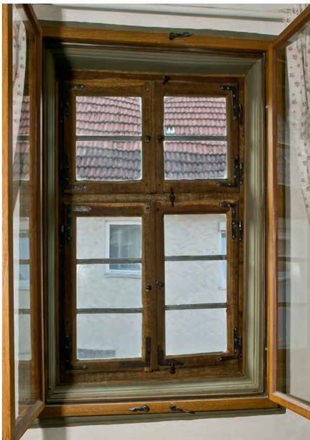
Die sorgfältig restaurierten historischen Fenster wurden für eine bessere Energiebilanz mit zusätzlichen Innenfestern ergänzt.
