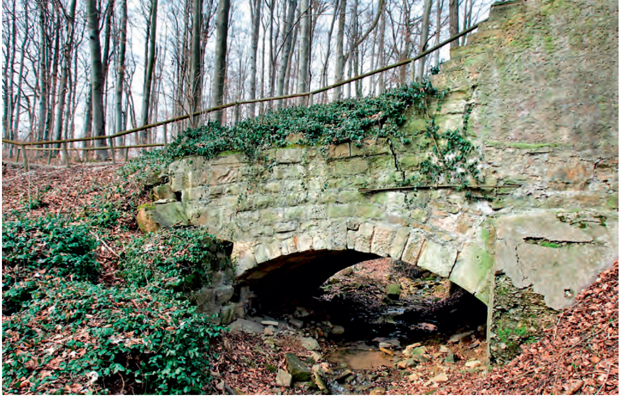
Die südliche, talseitige Wange der Teufelsbrücke ist stark vom Verfall gezeichnet. Das linksseitig anschließende Stützmauerwerk des Straßendamms ist auf einer Länge von 15 Metern vollständig abgegangen, ein Rest von ca. zwölf Metern noch erhalten.
