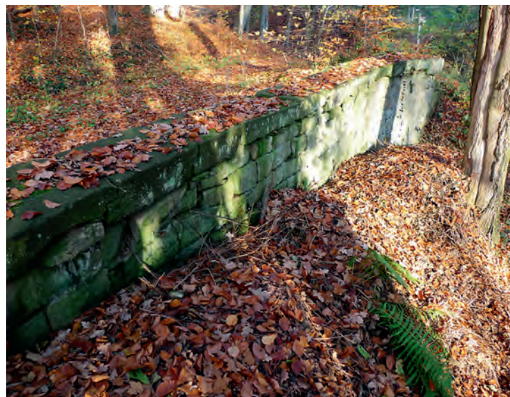
Brüstung und Reste der talseitigen Stützmauer des Straßendamms. Ein erheblicher Teil der Stützmauer ist erst vor wenigen Jahren in die Klinge abgerutscht.
