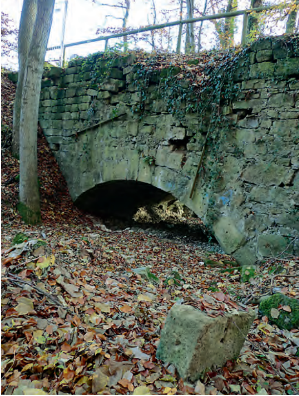
Die nördliche Wange mit dem noch gut erhaltenen Brückenbogen und der ungewöhnlich hoch aufragenden Brückenwange; im Vordergrund ein Deckstein der zahlreichen abgestürzten behauenen Steine aus der Brückenbrüstung mit den originalen Löchern für die Stahlklammern.
