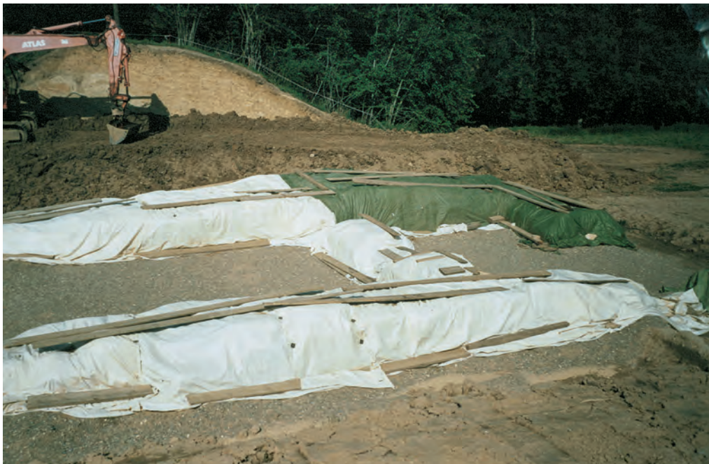
Wetterfest verpackt ist das 2.600 Jahre alte Steintor aus keltischer Zeit. Der hallstattzeitliche Wall oben hinter dem Bagger soll wieder bis zum Tor aufgeschüttet werden. Die nicht sichtbare Heuneburg liegt weiter rechts.
