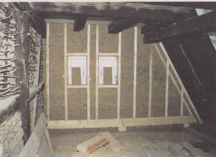
Oben: Innenseite einer Außenwand. Konstruktion und Füllung mit Holzleichtlehm vor der Montage mit Lehmbauplatten. Links ist eine altertümliche geflochtene Wand zu sehen.
