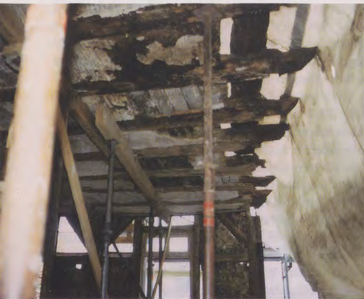
Herber Rückschlag für die Brettener Bürgerinitiative: Das Fachwerk an der Ostseite des Schweizer Hofes ist komplett verfault, auch das Dach musste völlig abgenommen werden.
