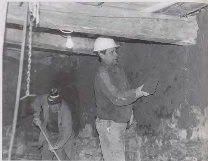
Neuer Lehmputz für die alten Mauern des Gerberhauses. Im Vordergrund Oberbürgermeister Paul Metzger.
