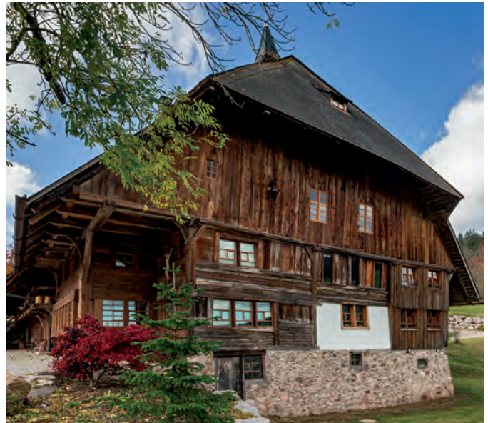
Ein mächtiges Zeugnis bäuerlicher Baukultur im Schwarzwald: der Wildenhof in Lenzkirch-Raitenbuch nach der Sanierung
