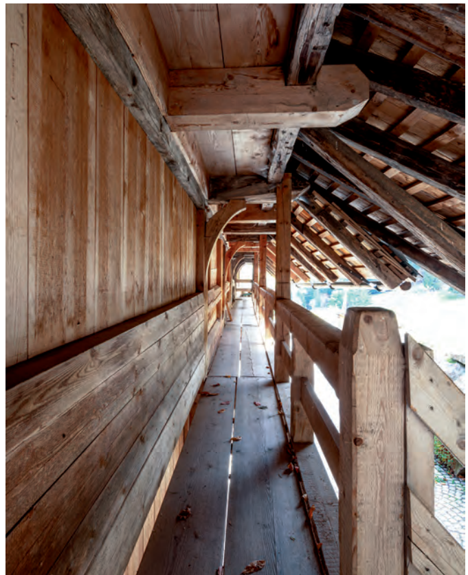
Handwerklich perfekte Zimmermannsarbeit, inzwischen schon wieder vom Wetter gezeichnet: der im ersten Bauabschnitt der 1990er-Jahre wiederhergestellte Außengang unter dem weit überstehenden Dach
