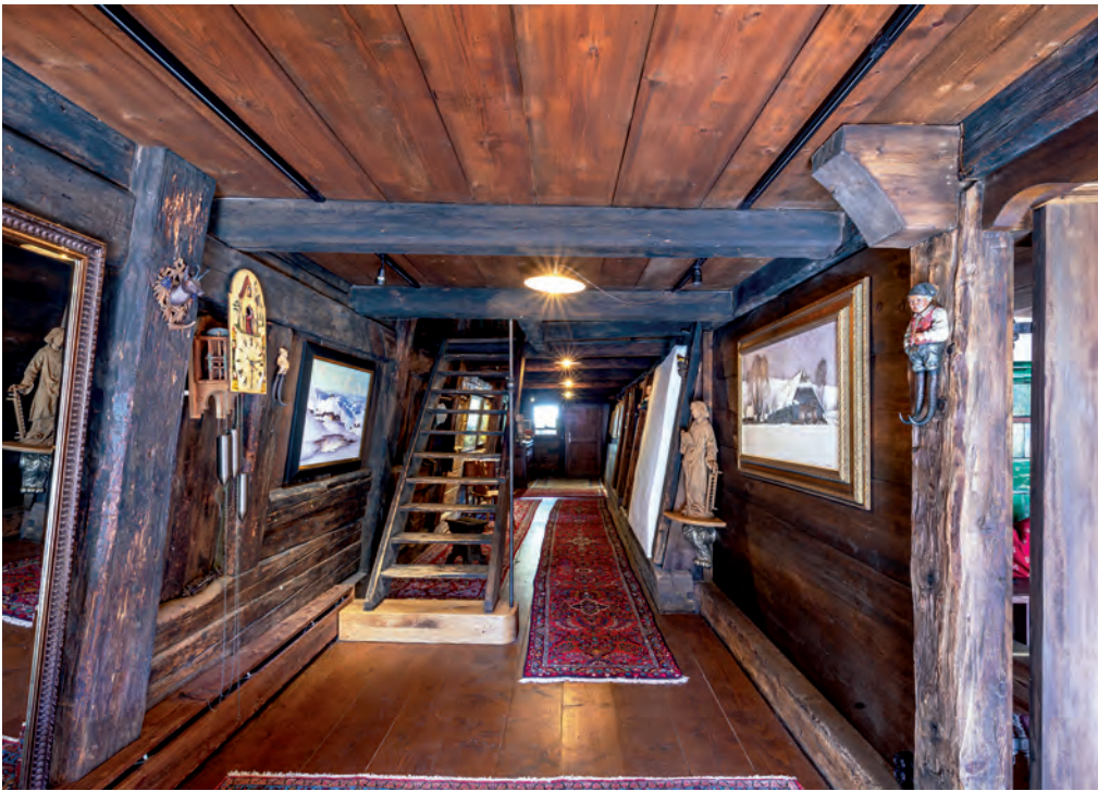
Im quer durch das Haus führenden Gang am besten zu erkennen: die starke Verformung des Hofes durch Berg- und Winddruck, vor der statischen Sicherung ein großes Problem
