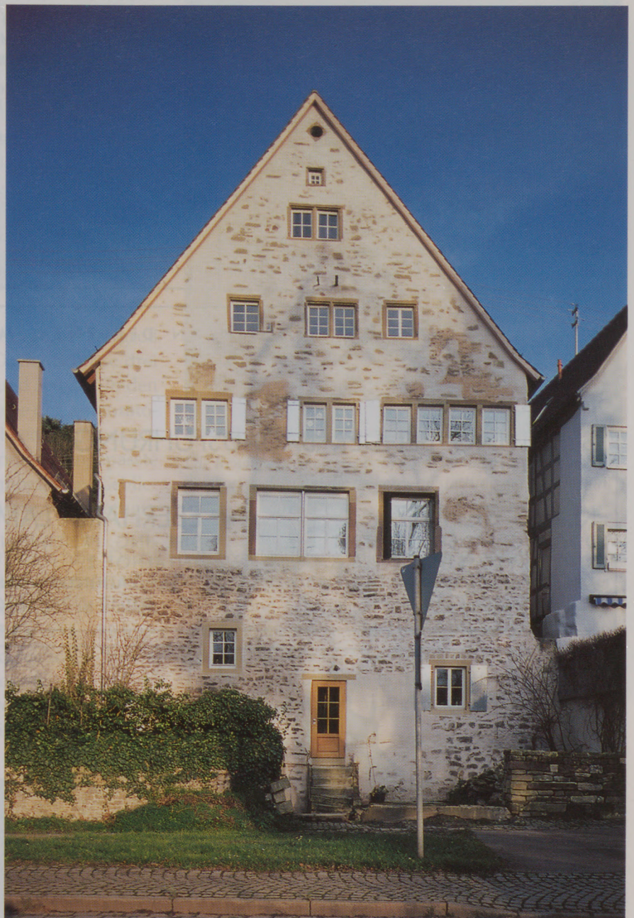
Stadtmaueransicht mit Steinfassade aus verschlammtem Bruchsteinmauerwerk.
