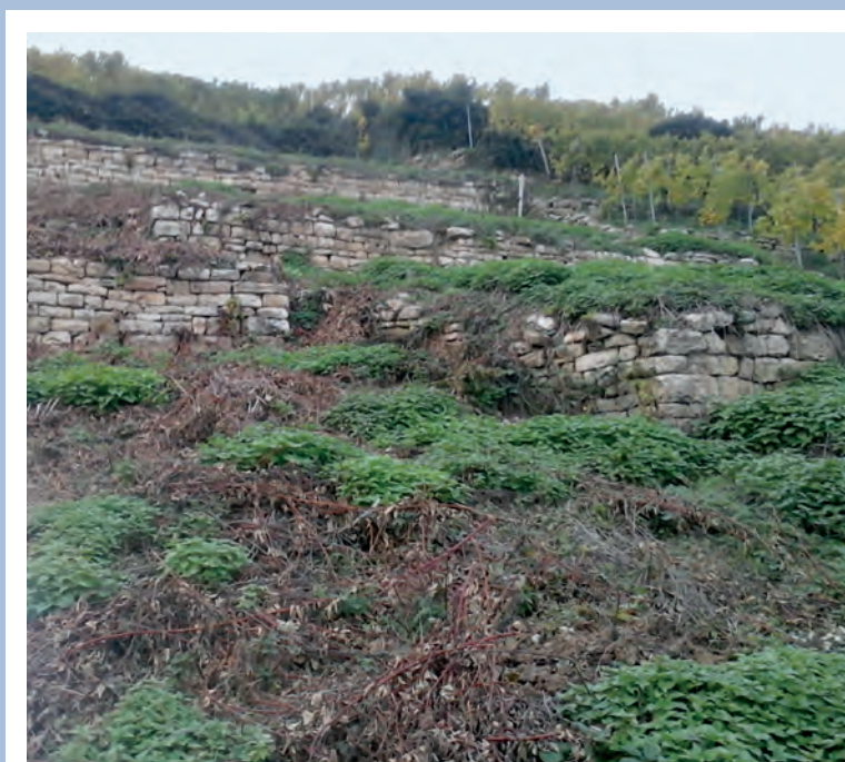
Die Weinbergsmauern in Auflösung, die terrassierten Böden beginnen zu erodieren und eine Hochstaudenflur als Vegetationsdecke – so sah es vor Beginn der Sanierung an vielen Stellen im Weinberg aus.
