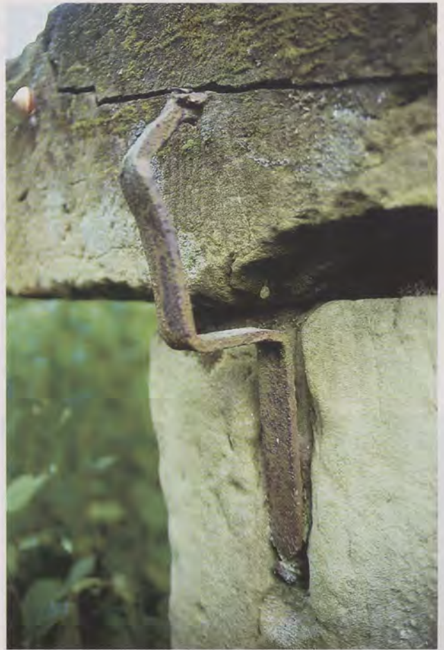
Eine eiserne Klammer an einer defekten steinernen Ruhebänk: Sie sollte einst den Sturzstein fest auf den Pfeilern halten, doch der Sturzstein brach. Gut sichtbar ist die mit Widerhaken versehene geschmiedete Verankerung (oben), die einst, von Blei umgeben, auch im oberen Stein festsaß. Unten ist die Befestigung noch einigermaßen intakt.
