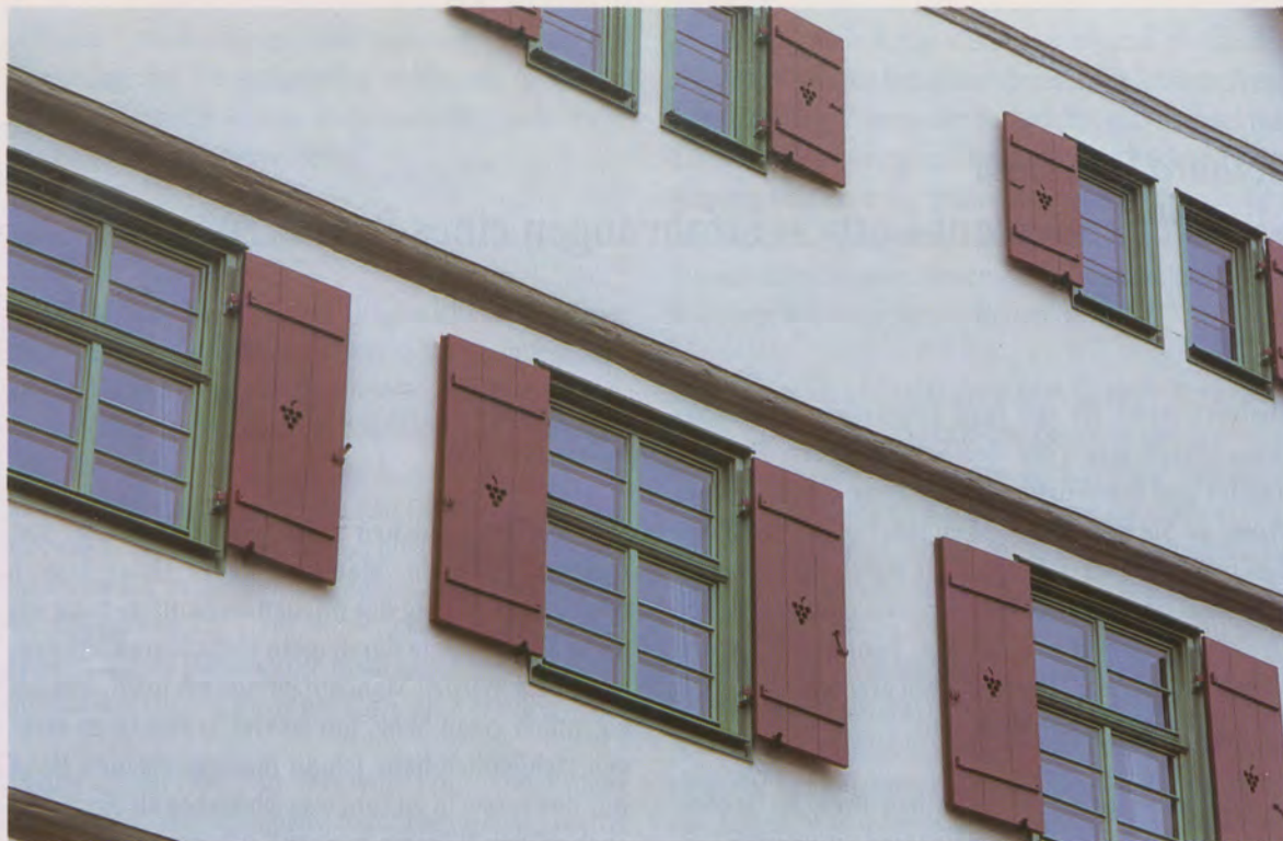
Ausschnitt der Fassade mit Sprossenfenstern und Klappläden, die nach historischem Befund erneuert wurden.
