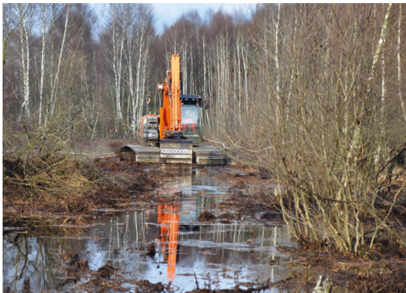
Trotz seines hohen Gewichts weist der Moorbagger aufgrund seiner breiten Ketten einen geringeren Bodendruck auf als ein menschlicher Fuß! Solch leistungsfähige Maschinen sind bei der Wiedervernässung von Mooren unersetzlich.
