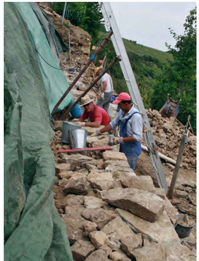
35 km Trockenmauern aus Muschelkalk instand zu halten, ist eine Daueraufgabe für die Roßwager Weinbauern und neben der Arbeit mit hohen Kosten verbunden.
