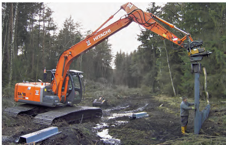
Ein Spezialbagger der Firma Strobel, Pfullendorf, baut eine Spundwand zur Wiedervernässung im Teilgebiet «Obere Schnöden» ein.
