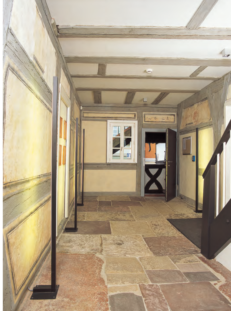
Der Mittelflur im ersten Obergeschoss des Nonnenhauses mit freigelegten Malereifragmenten des frühen 17. Jahrhunderts.
