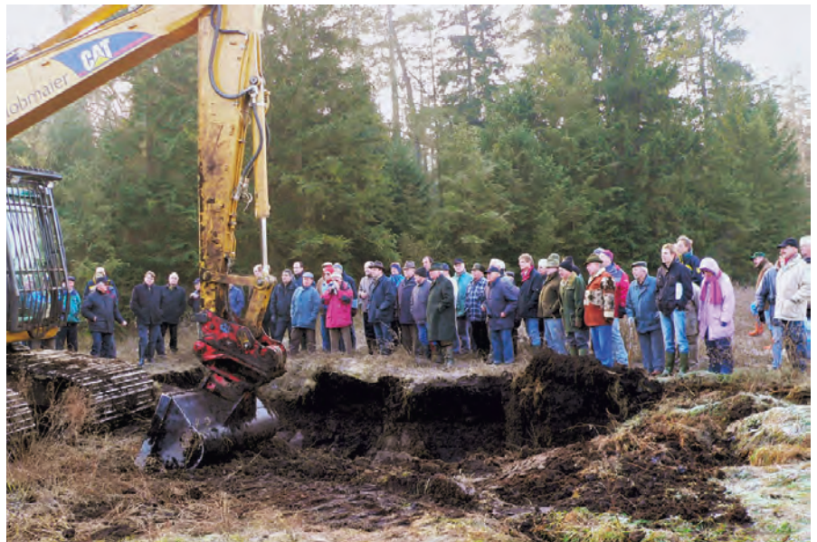
Ein Spezialbagger hebt Boden für ein Querbauwerk aus. Um die Druckbelastung auf dem empfindlichen Moorboden zu verringern, beträgt die Spurbreite je 1,40 Meter.
