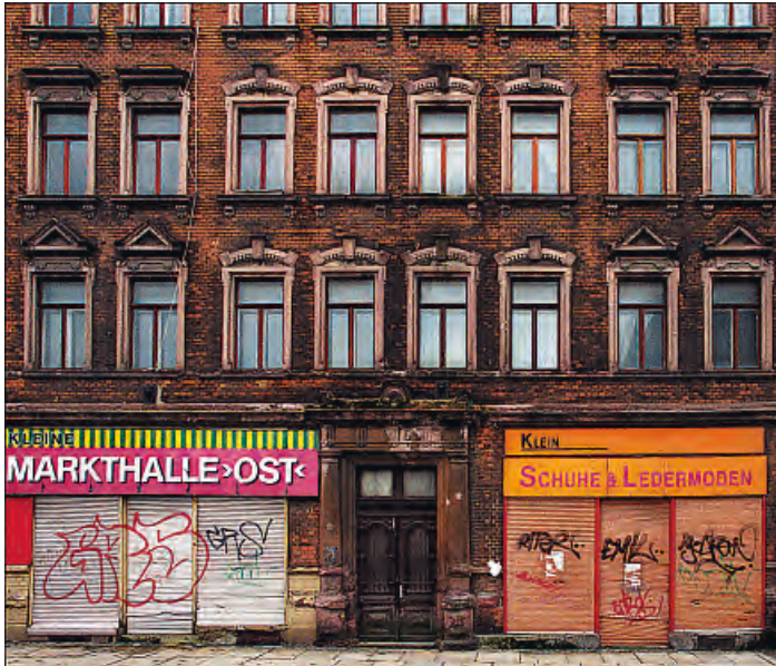
Sterbende Wohnquartiere in den Großstädten: hier ein erschreckendes Beispiel aus Chemnitz.
