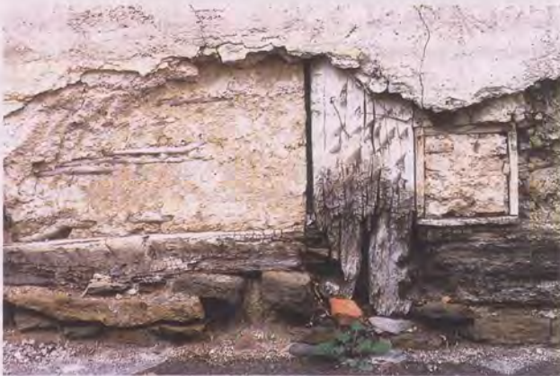
Nordseite des denkmalgeschützten Hauses Rathausstraße 1 in Beuren: Die Schwellbalken und der Fuß des Fachwerkständers können in diesem Zustand nur noch ersetzt werden.
