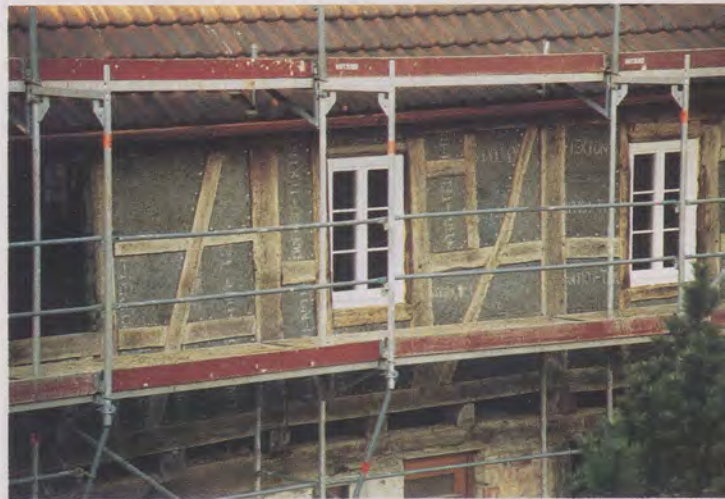
Die Holzwolle-Leichtbauplatten sind als äußere Schalung für den Holzlehm und als Grundlage für den Außenputz in den einzelnen Gefachen gut zu erkennen.
