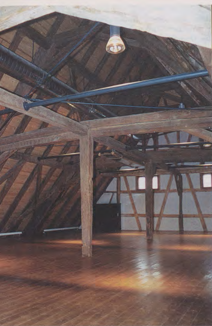
Blick in den Veranstaltungsraum im Dach der Alten Scheuer mit eisernen Verstrebungen und einem Rohr für die moderne Haustechnik.
