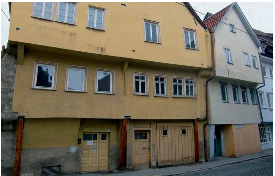
Links im Bild Oberamteistraße 30/32, das wie sein Nachbar die mittelalterliche Bauweise mit den markanten Geschossvorstößen auf besondere Weise anschaulich macht und erahnen lässt, welche wertvolle Bausubstanz sich dahinter verbirgt.
