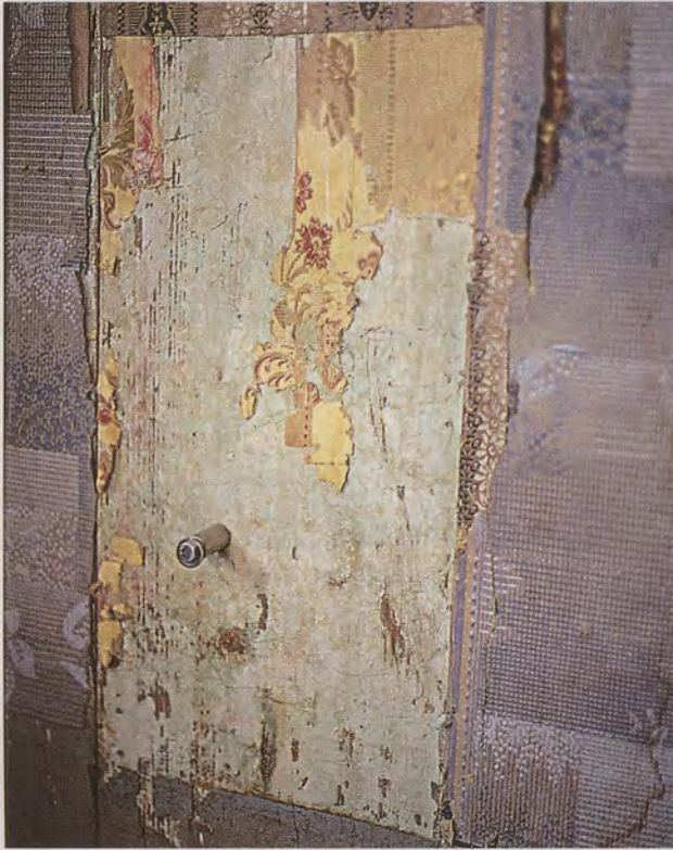
Vier Tapetenschichten übereinander und «in situ», geschützt durch eine Plexiglasscheibe.
