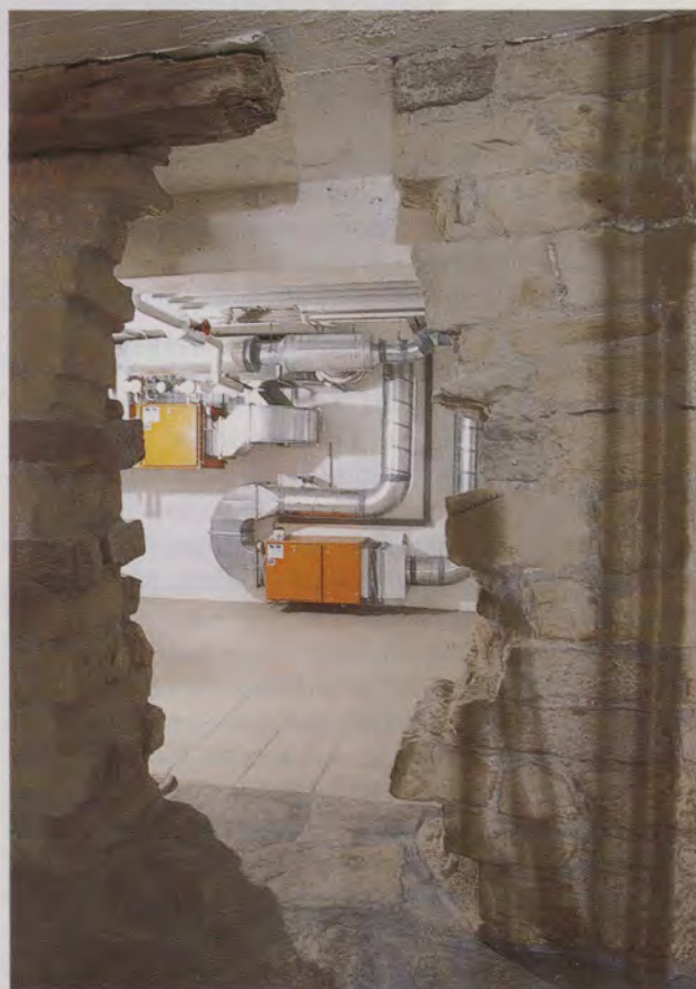
Neues in alter Umgebung: Lüftungsanlage im Untergeschoß.
