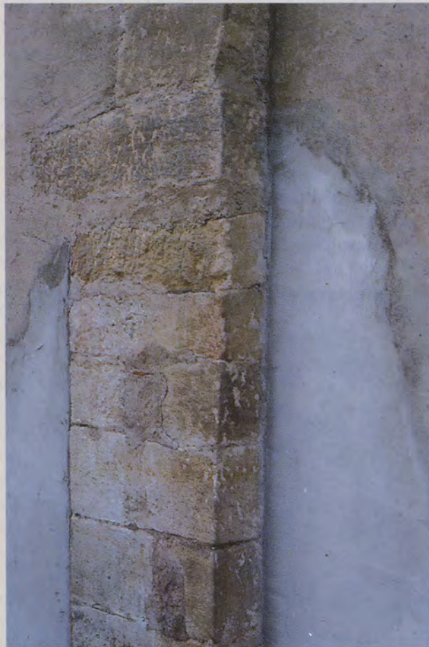
Hier könnte der bei Eyselin noch 1619 erwähnte «Schwibbogen» der alten Hofkapelle angesetzt haben. Die zunehmend schräg verlaufenden Fugen der Sandsteinquader zeigen den Ansatz eines Bogens. Die groben Ecksteine darüber wurden 1627 aufgesetzt.
