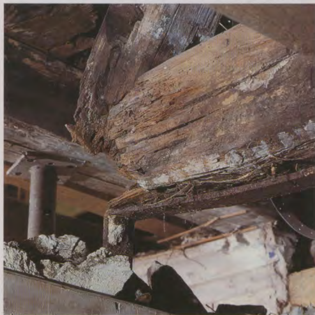
Größere Schäden wurden im Dachbereich festgestellt. Reparieren ist hier nicht mehr möglich, – hier hilft nur noch erneuern.
