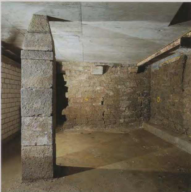
Ein Blick in das Untergeschoß, wo die vorgefundene Säule tatsächlich tragendes Element ist. Der Raum wird künftig als Garderobe für den Veranstaltungsraum genutzt.
