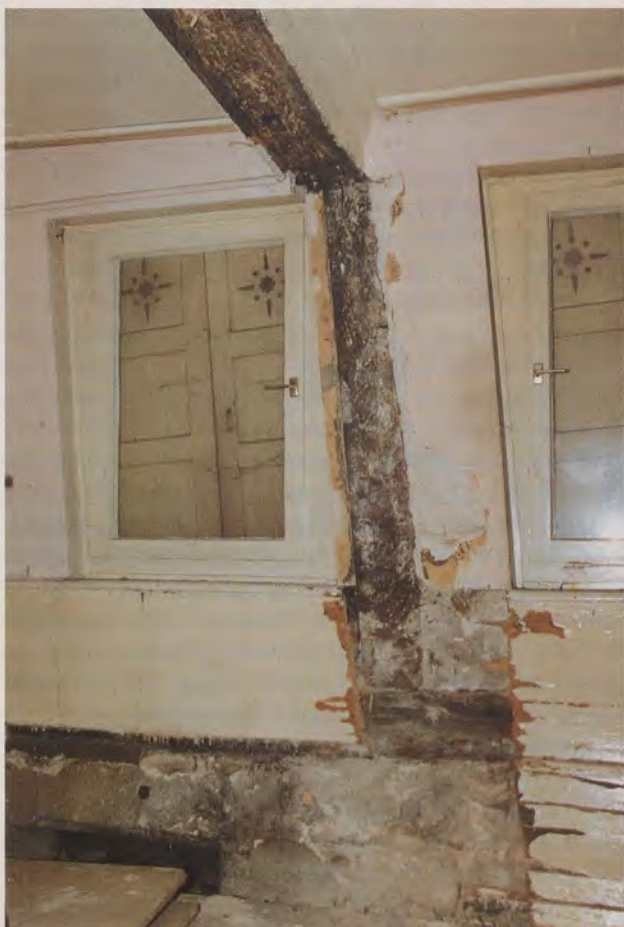
Weberstraße 2, Haupthaus; mittlerer Bundständer in der Nordwand des Erdgeschosses, von Süden. Die beiden Zapfenlöcher in Ständer und Unterzug (für die aussteifende Kopfstrebe) belegen, daß im Erdgeschoß nie eine Mittellängswand bestand.
