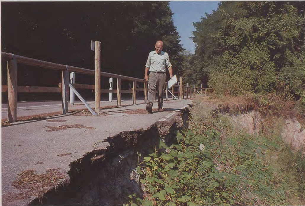
Der Stuttgarter Forstdirektor Fritz Oechßler schreitet an der Stelle über die Kreisstraße K 1659, an der auf 25 Meter Länge Bankett und Teile der Fahrbahn abgerutscht sind. Er kämpft darum, diese überflüssige Verbindung Solitude–Schillerhöhe bis auf den Busverkehr zu schließen.
