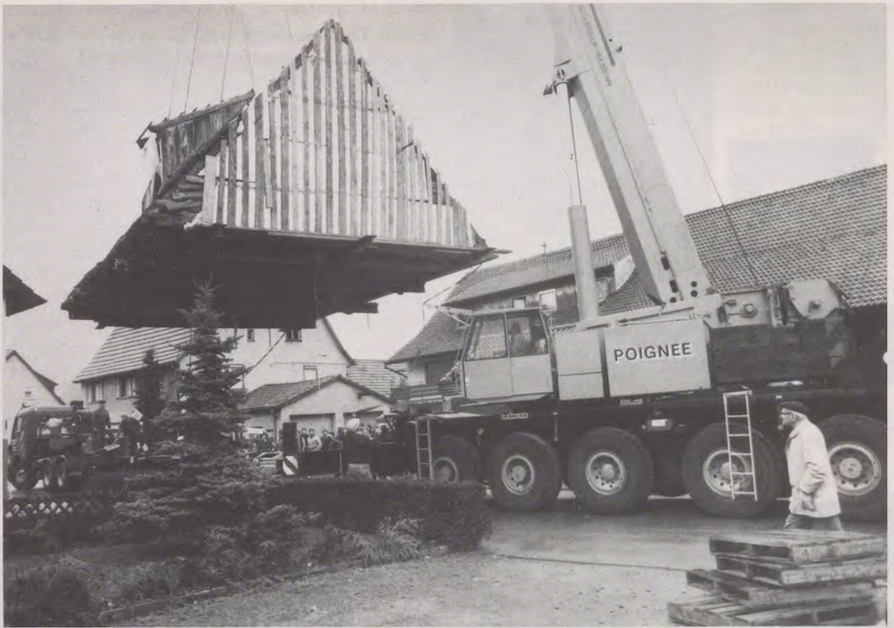
In Hößlinsülz ist das Dach des Armenhauses mit einem Kran komplett abgehoben, wird geschwenkt und auf einen Tieflader gesetzt. Möglichst viel originale Substanz konnte so erhalten werden. Rechte Seite: Die massiven Wände des Armenhauses sind in Wackershofen bis zum Wiederaufbau zwischengelagert.
