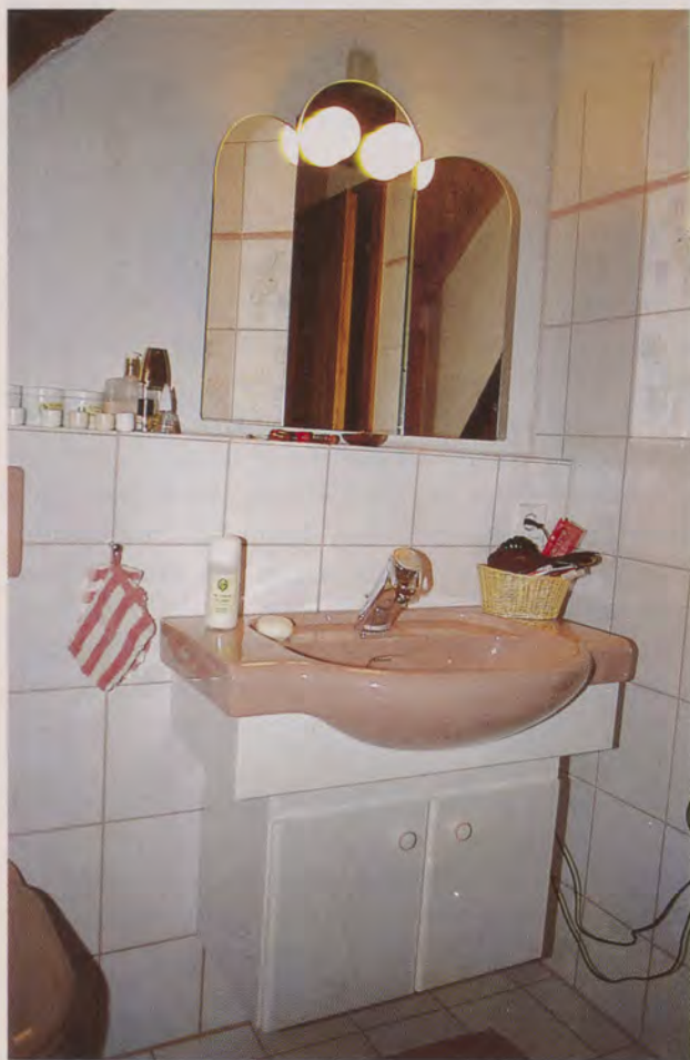
Teilansicht des Bades im zweiten Obergeschoß. Auch in einem alten Haus braucht man auf modernen Wohnkomfort nicht zu verzichten. Die Installation der Leitungen war allerdings sehr aufwendig.
