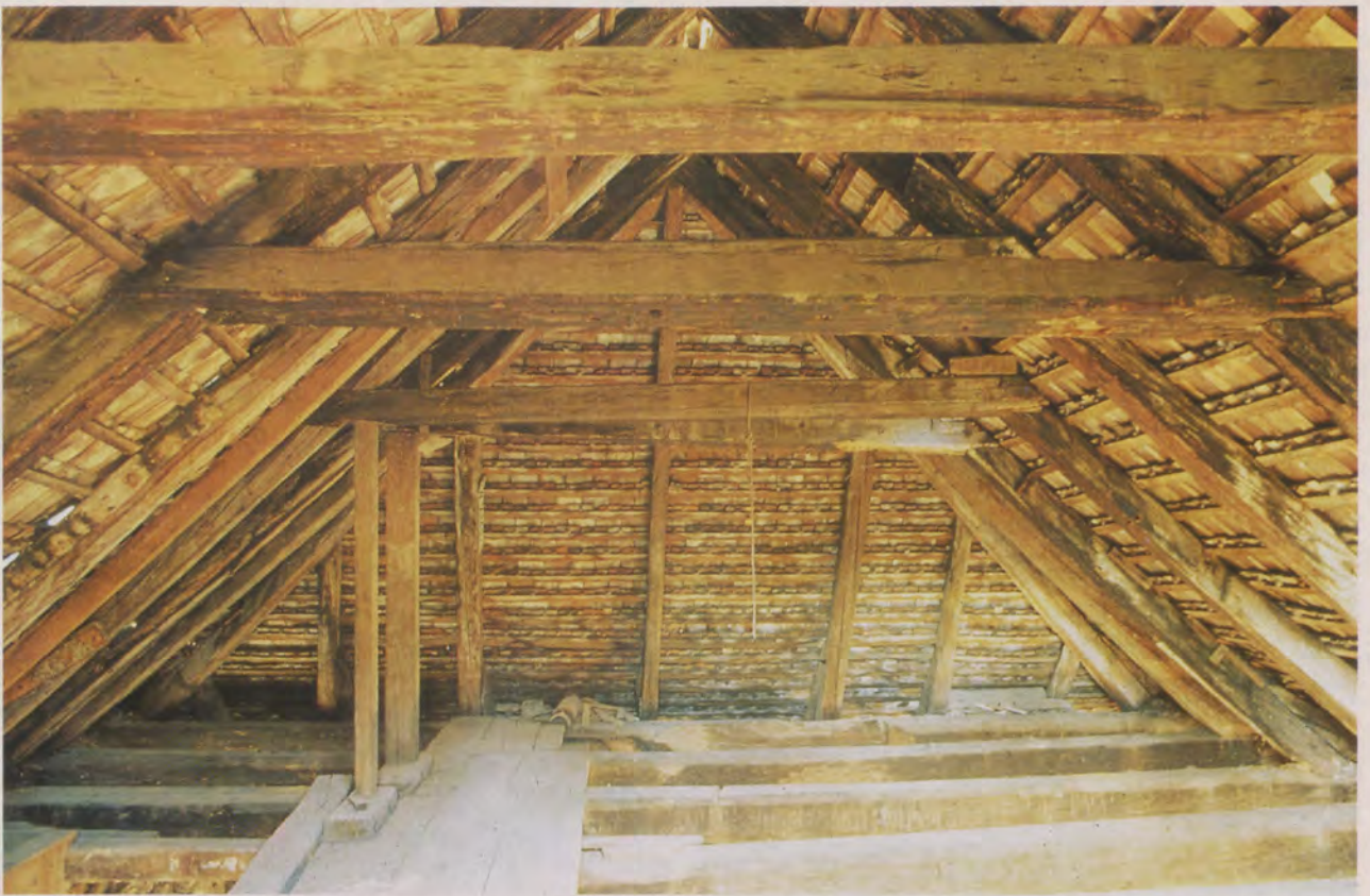
Das Dachgeschoß wurde laut dendrochronologischer Untersuchung um 1350 so umgebaut, wie es im Bild zu erkennen ist. Fast alle Balken aus Tanneholz konnten wieder verwendet werden. Die Imprägnierung mit Ruß und Tierblut verhinderte den Wurm- und Käferbefall.
