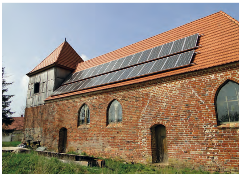
So weit ist es in Baden-Württemberg noch nicht, aber am Dach der Kirche in Müßelmow, Mecklenburg-Vorpommern, wird deutlich, in welchem Maß Photovoltaik auf das Erscheinungsbild eines Denkmals Einfluss nimmt.
