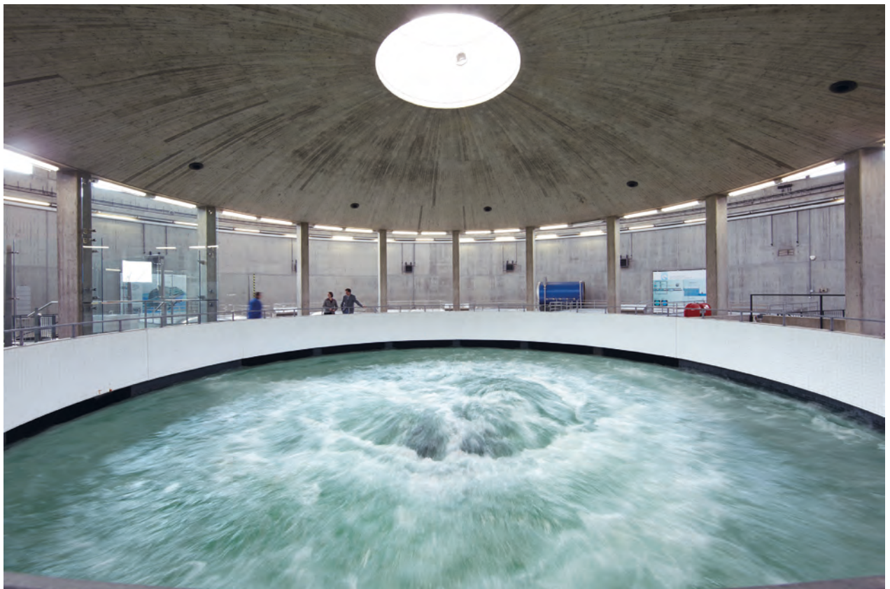
Trinkwasserfassung der Bodensee-Wasserversorgung auf dem Sipplinger Berg
