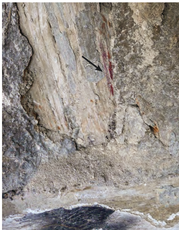
Die offenen Fugen an den Verpflockungen der Deckenschirmbalken belegen beispielhaft, dass das Holz des «Feldhäusles» fällt frisch verarbeitet wurde und stark geschwunden ist.
