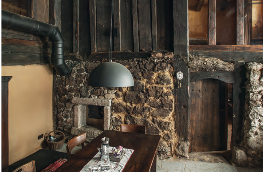
Die von ihrer eingezogenen Zwischendecke befreite Rauchküche mit roher Steinmauer und Durchgang zum Vorratsraum.
