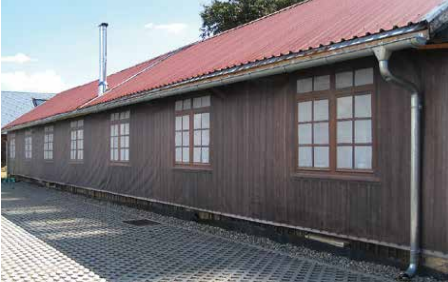
Abb. 23 - Ehemalige Wehrmachtsbaracke im Jahr 2020. Ein Kunststoffvorhang mit aufgemalter Fassadenstruktur und Fenstern überdeckt den teilweise maroden Zustand (Foto: Privat).
