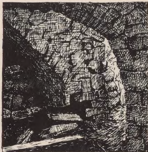
Abb. 13: Stumpf, Vormauer und Ziegelausbesserung oben am Eingang
